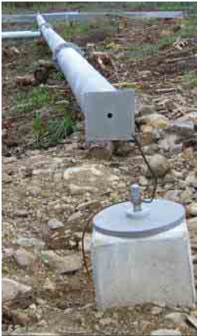
Kuva 4. Pylväsjalan perustus ja maadoituselektrodijohdin.
