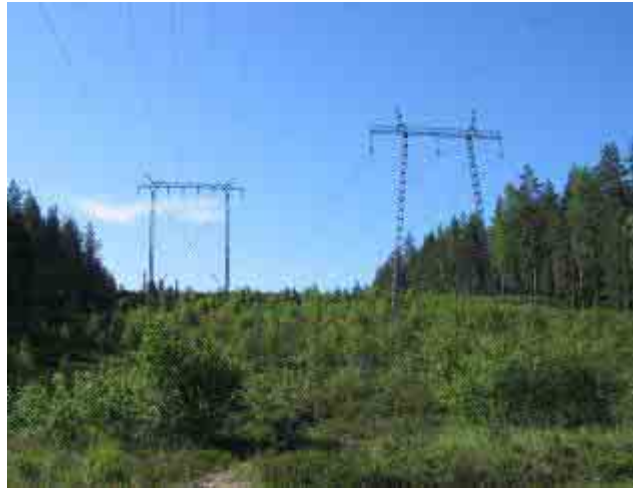
Kuva 25. Peuranpään ja Hikiän välillä uusi 400 kV voimajohto sijoittuu vastemmanpuoleisen 110 kV kaksoisjohdon paikalle. Oikealla 220 kV rakenteinen voimajohto.
