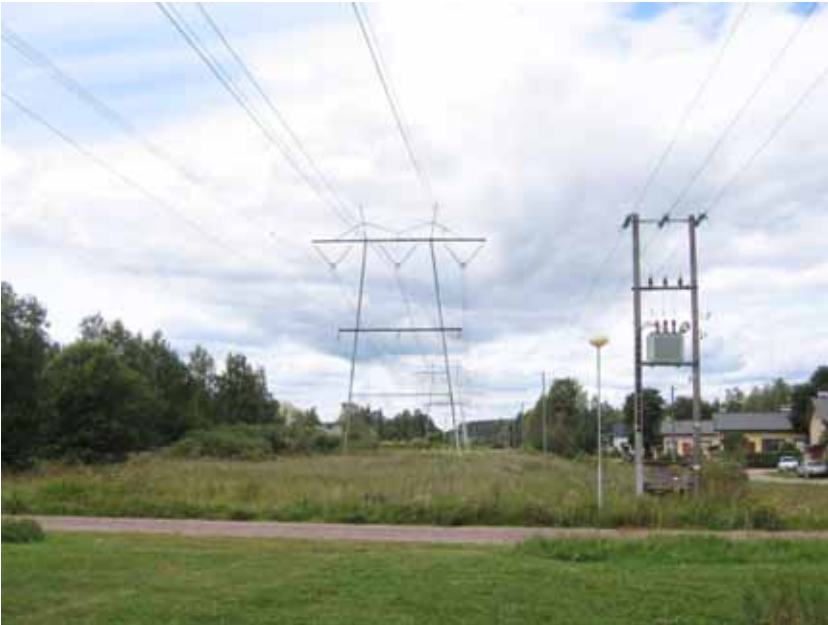
Kuva 42c. Alavaihtoehdon B, C tai D toteutuessa Riihimäen taajamaan jäävä saneerattu 110 kV voimajohto.
