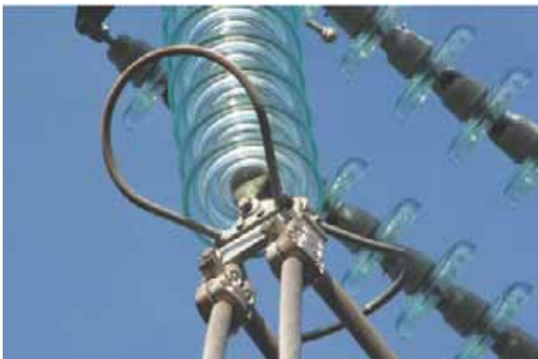
Kuva 87. Voimajohtojen eristimissä esiintyy koronapurkauksia.
