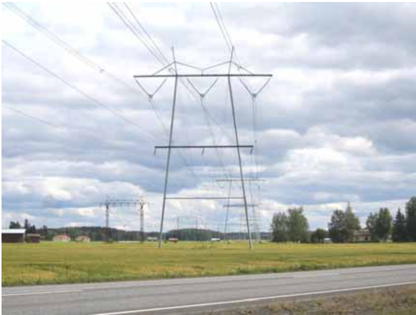
Kuva 37. Tammelan Riihivalkamassa on nykyään 400+110 kV ja 2x110 kV voimajohdot.
