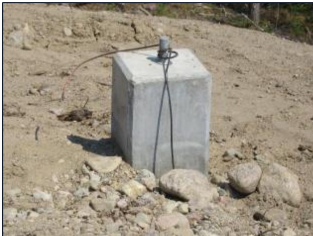
Kuva 3.5. Pylväsjalan perustus ja maadoituselektrodijohdin.
