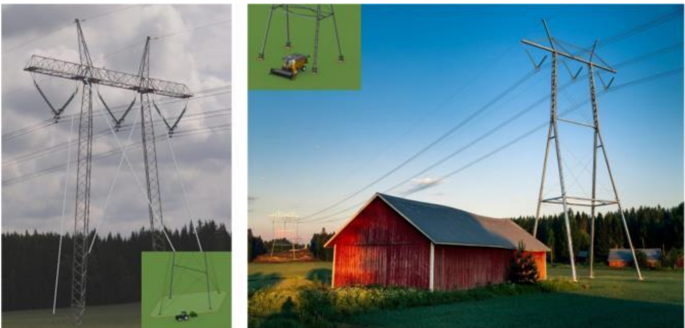
Kuva 4.13. 400 kilovoltin pylvästyyppiä. Vasemmalla harustettu portaalipylväs (peruspylvästyyppi) ja oikealla harustamaton peltopylvästyyppi.
