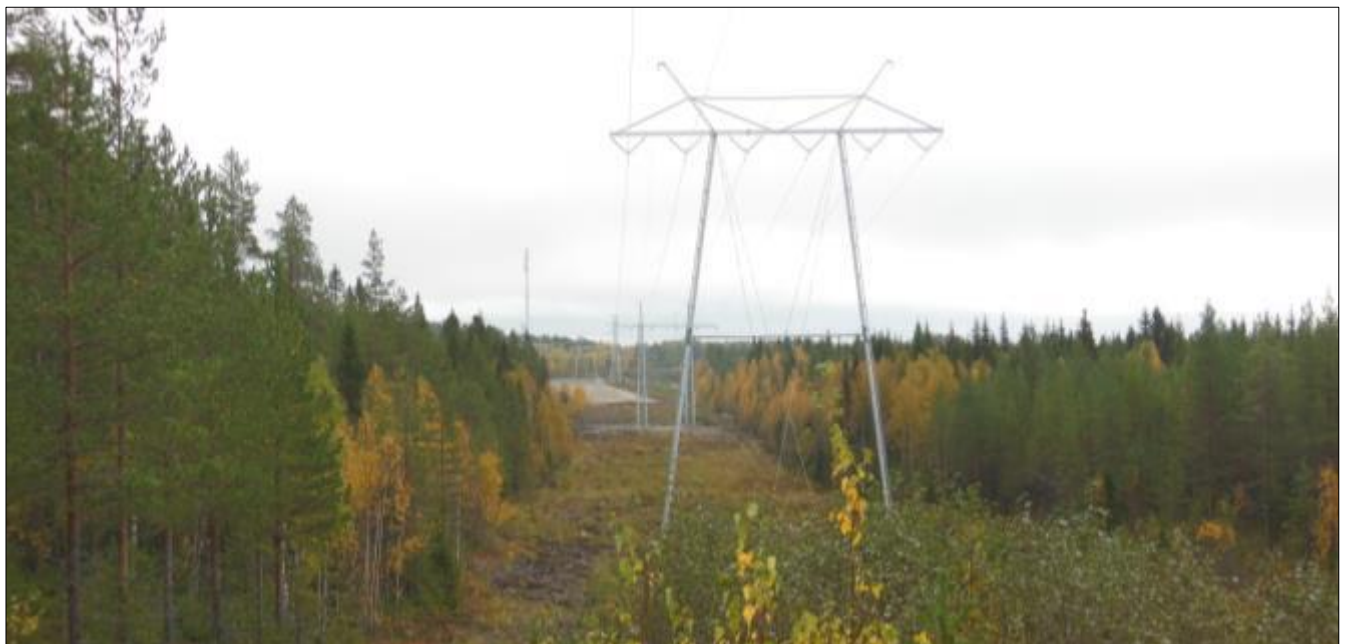
Kuva 4.15. 110 kilovoltin kahden virtapiirin harustettu portaalipylväs, jossa virtapiirit ovat samassa tasossa.
