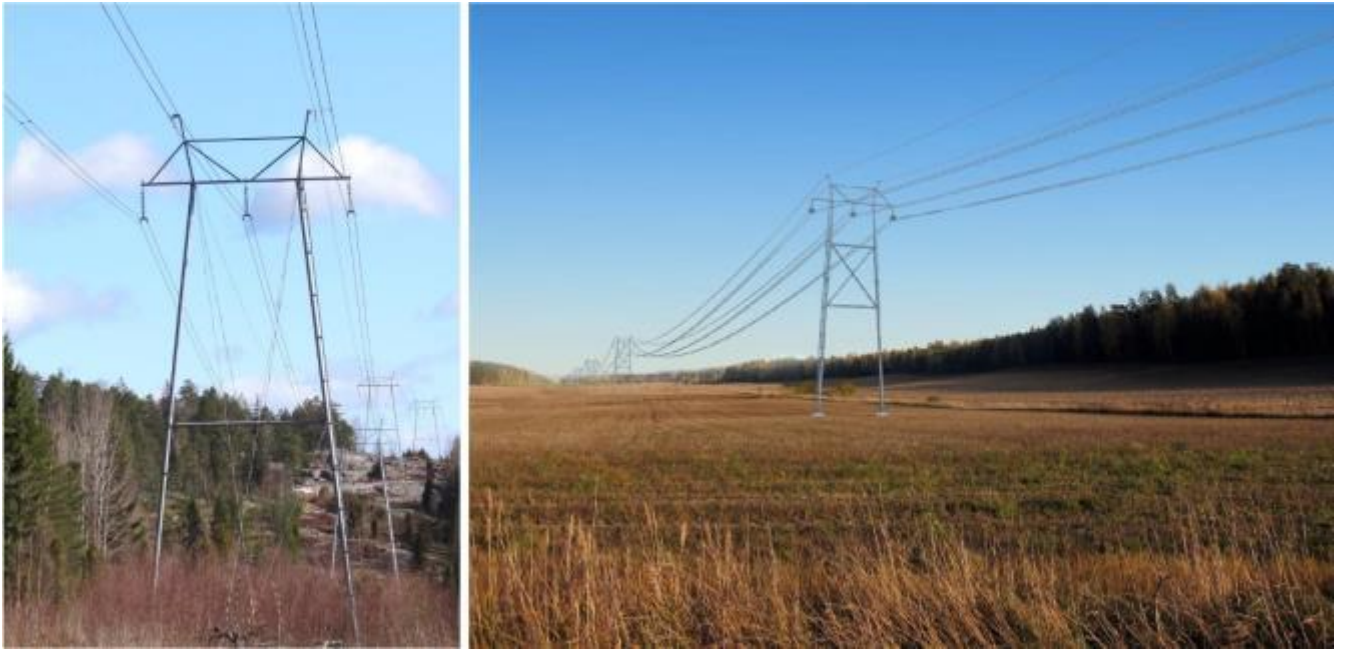
Kuva 4.14. 110 kilovoltin pylvästyyppejä. Vasemmalla harustettu portaalipylväs (peruspylvästyppi) ja oikealla harustamaton peltopylvästyppi.
