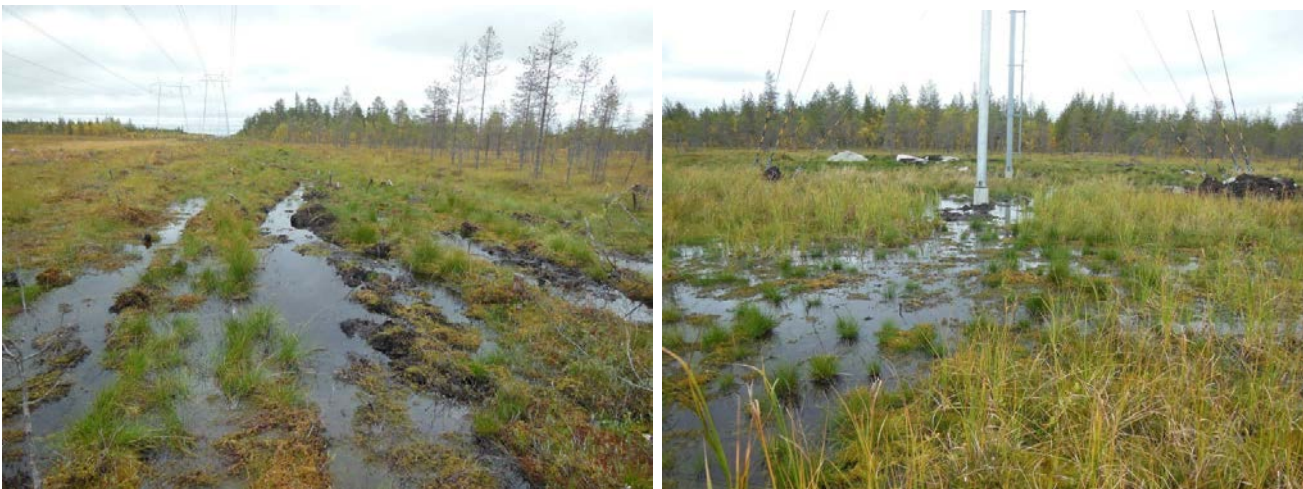
Kuva 73. Voimajohdon rakentamisesta aiheutuneita jälkiä nevarämeellä. Johtoalueelta on poistettu suomännnyt. Voimajohdon rakentamisesta on syntynyt ajouria, joissa pintakasvillisuus on vaurioitunut. Pylväspaikan perustamistöistä jäävät muutokset rajoittuvat perustusten lähiympäristöön.
