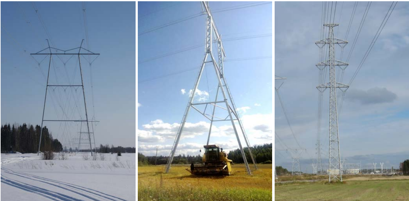
Kuva 21. Esimerkkejä eri pylvästyypeistä. Vasemmalla 400+110 kilovoltin haruksin tuettu teräksestä valmistettu portaalipylvä, keskellä vapaasti seisova harukseton peltopylväs ja oikealla vapaasti seisova t-pylvä.
