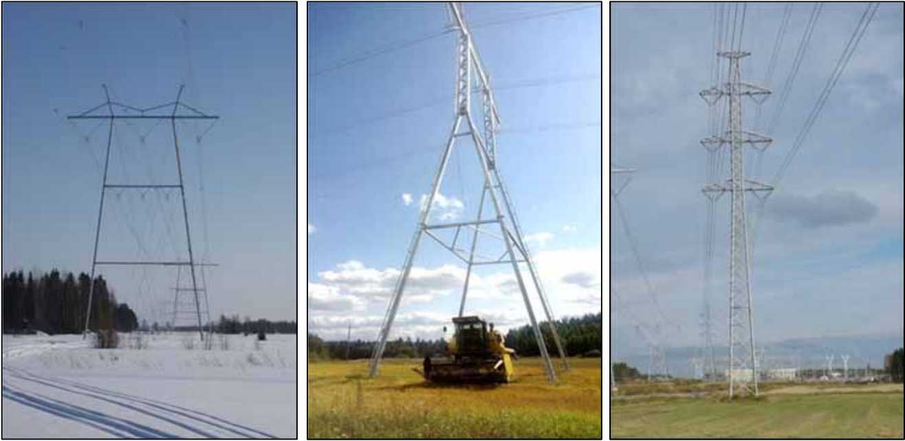
Kuva 27. Esimerkkejä eri pylvästyypeistä. Vasemmalla 400+110 kilovoltin haruksin tuettu teräksestä valmistettu portaalipylvä, keskellä vapaasti seisova harukseton peltopylväs ja oikealla vapaasti seisova t-pylväs.
