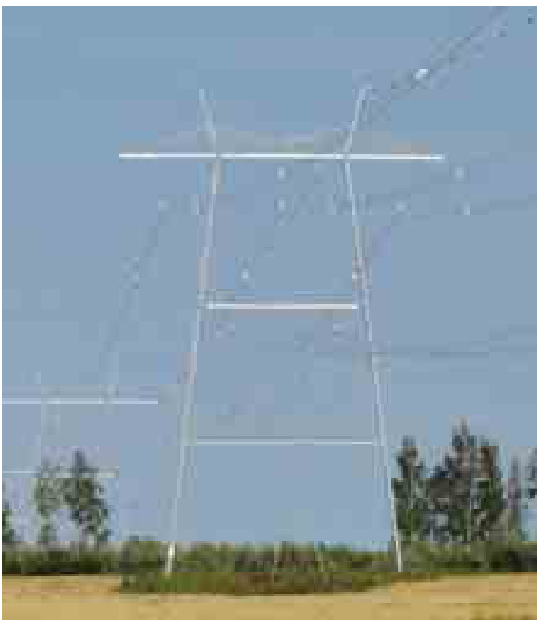
Kuva 18. Harustettu 400 + 110 kV portaali-pylväs.
