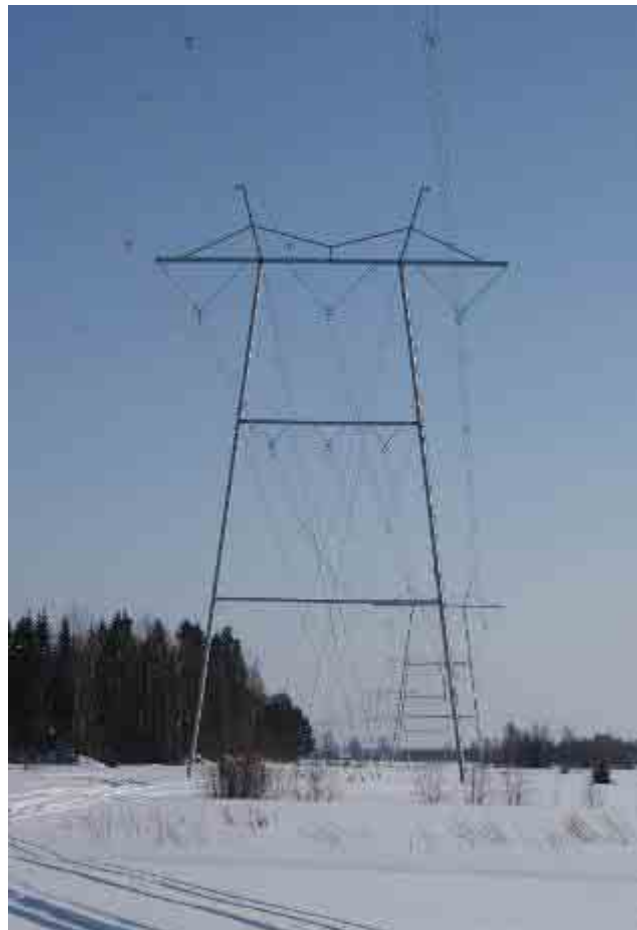
Kuva 30. Harustettu 400 + 110 kilovoltin portaalipylväs.
