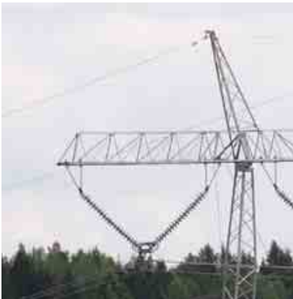
Kuva 153. Voimajohtopylvään eristimiä, joissa koronapurkauksia voi esiintyä.
