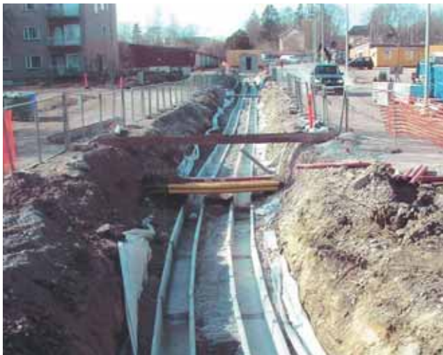
Kuva 6-1. Esimerkki 110 kV maakaapelin työ- maasta, jonka tarvitsema kaivanto on 400 kV kaapelia huomattavasti pienempi (Helsingin Sähköverkko Oy).
