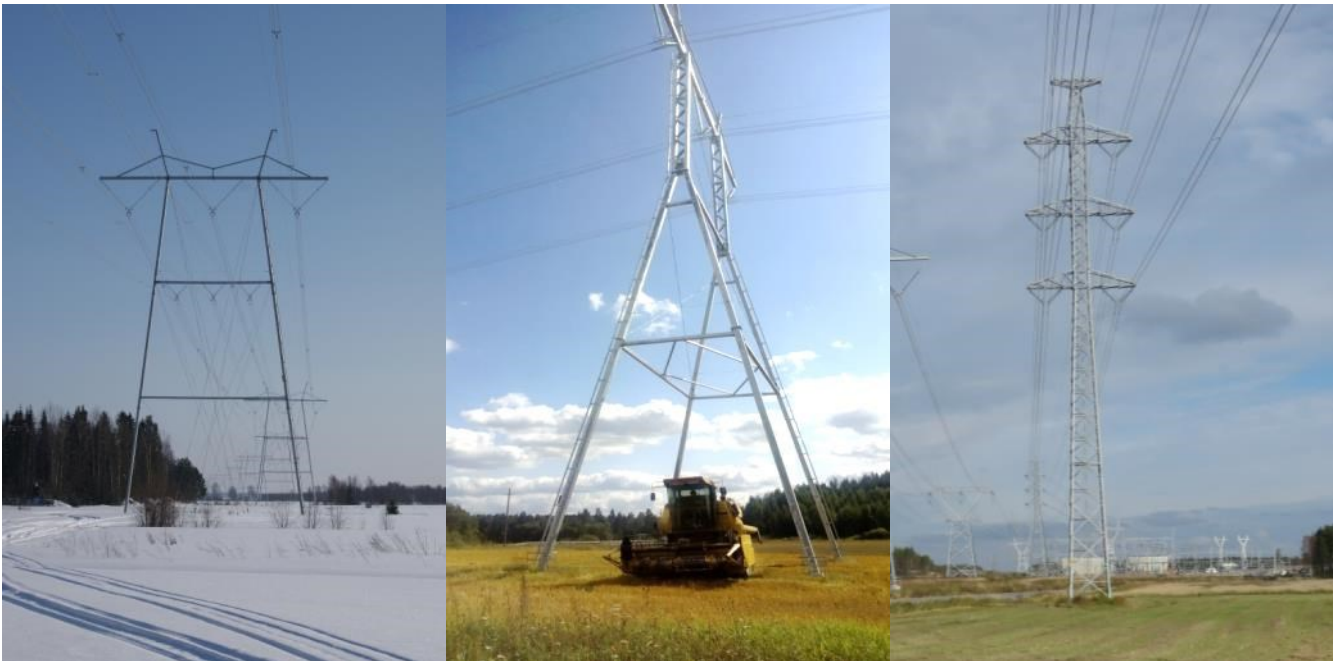
Kuva 4.3. Esimerkkikuvat eri pylvästyypeistä. Vasemmalla perusratkaisun mukainen 400+110 kilovoltin haruksin tuettu por-taalipylväs, keskellä vapaasti seisova harukseton peltopylväs ja oikealla vapaasti seisova t-pylväs.
