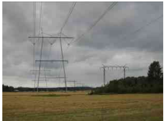
Kuva 7-10. Esimerkki nykyisenmallisesta (ns. Rautarouva, kuvassa oikealla) ja tulevasta (teräsportaalipylväs, kuvassa vasemmalla) pylvästyypistä rinnakkain.
