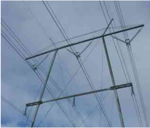
Kuva 4-3. Yhteispylväsrakenteen 400 kilovoltin voimajohdossa osajohtimia on vaihetta kohti kolme (ylempi orsi) ja 110 kilovoltin voimajohdossa kaksi (alempi orsi).
