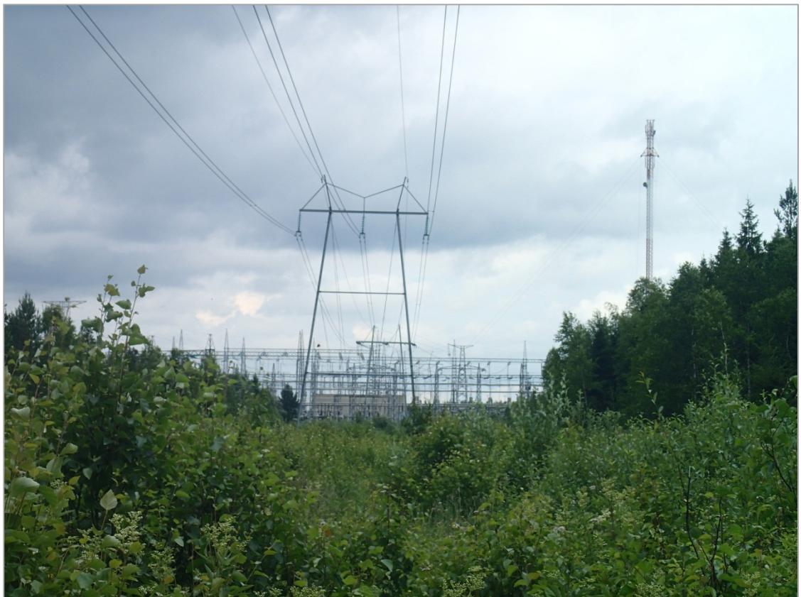
Kuva 27. Johtoreitin saapumiskohta Keminmaan sähköasemalle.
