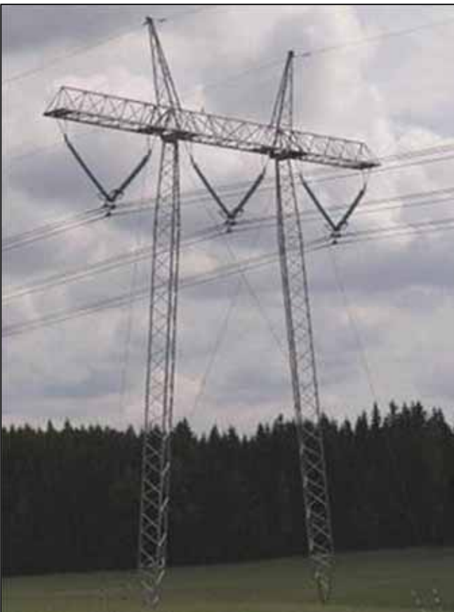
Kuva 20. Harustettu 400 kilovoltin portaalipylväs.
