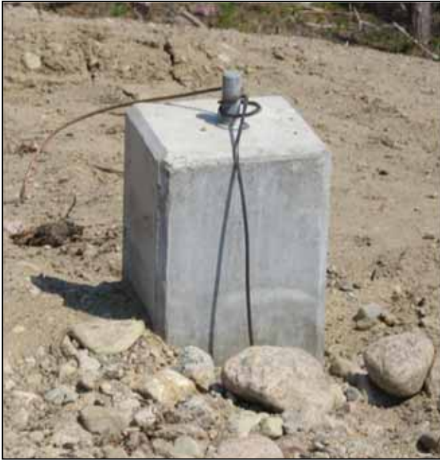
Kuva 11. Pylväsjalan perustus ja maadoituselektrodijohdin.
