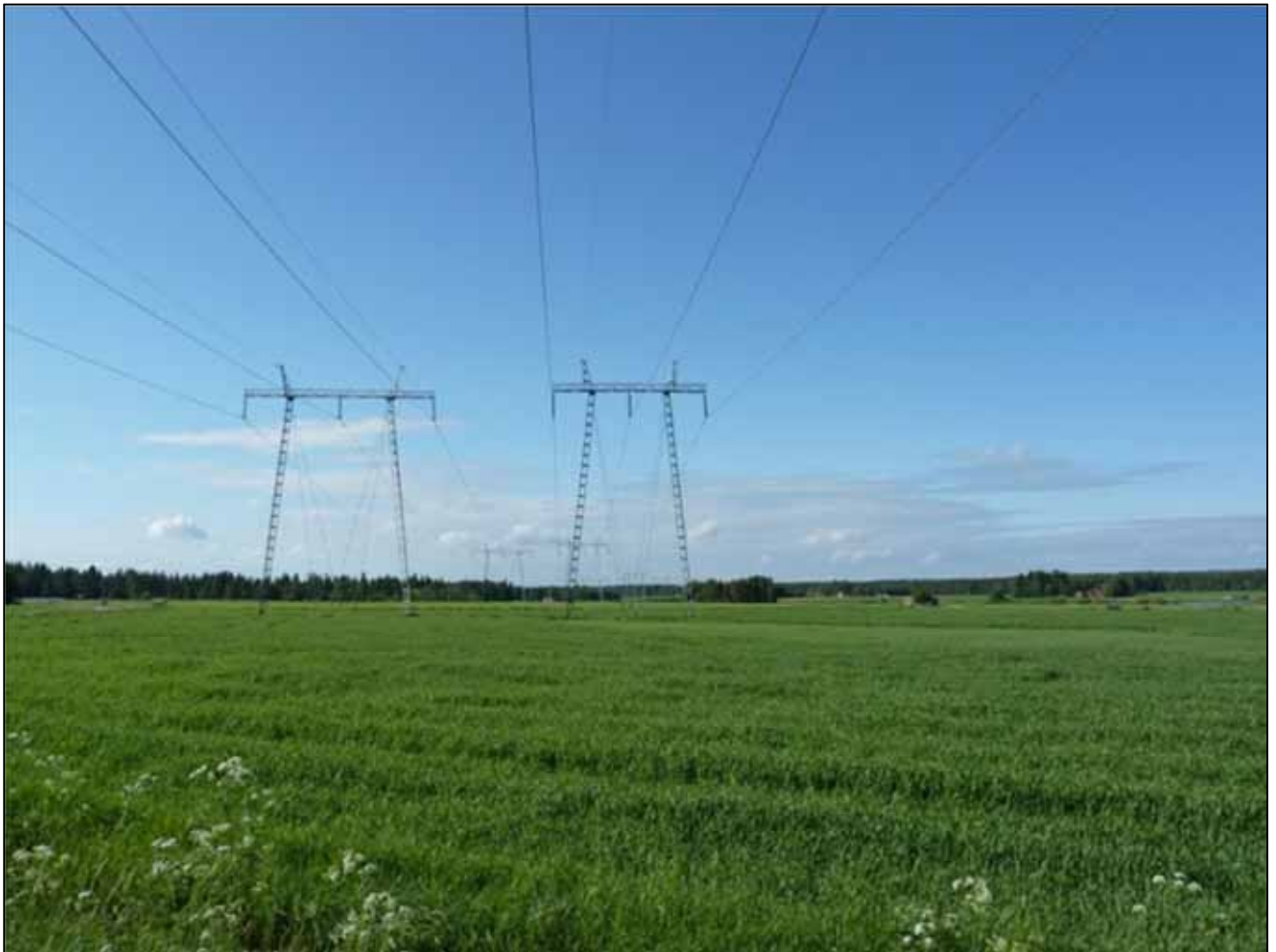
Kuva 95. Kalajokilaaksossa tarkasteltava voimajohto sijoittuu nykyisen 220 kilovoltin tilalle (kuvassa vasemman puoleinen). Uusi pylvästyyppi on nykyistä suurempi, jonka vaikutus maisemakuvaan voimajohtoreitin läheisyydessä on kohtalainen.
