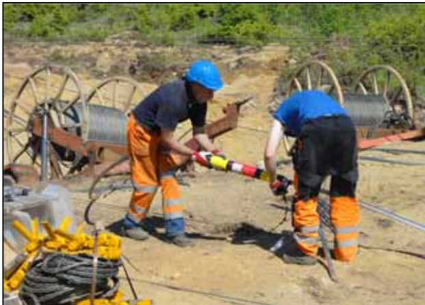
Kuva 162. Voimajohtojen johdinten liittämisenä käytetään räjäytettäviä liitoksia.
