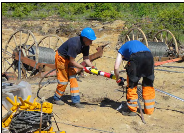
Kuva 88. Voimajohtojen johdinten liittämisenä käytetään räjäytettäviä liitoksia.
