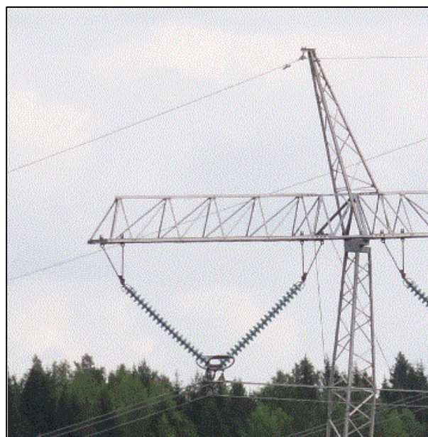
Kuva 89. Voimajohtopylvään eristimiä, joissa koronapurkauksia voi esiintyä.
