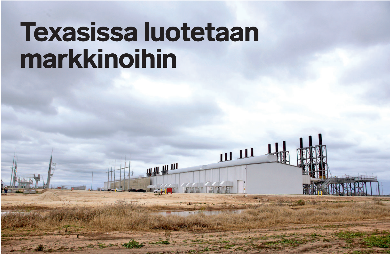
Pearsallin kaasuvoimalaitos sijaitsee San Antonion lähellä Texasissa.
