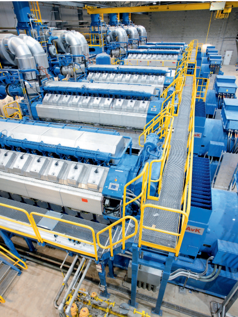
Pearsallin kaasuvoimalaitoksen konehalli.
