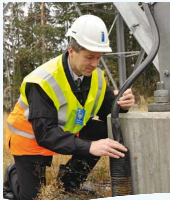
Ari Silfverberg tarkastaa valokaapelia Melon kytkinasemalla.
