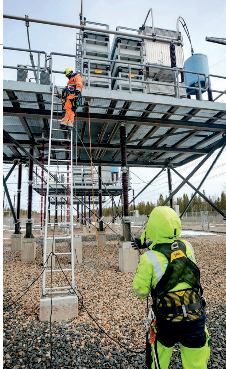
Keminmaan sähköasemalla rakenteet ovat asianmukaiset, mutta esimerkiksi tikkailta poistumisen yhteyteen tarvitaan lisää kiinnityspisteitä.
