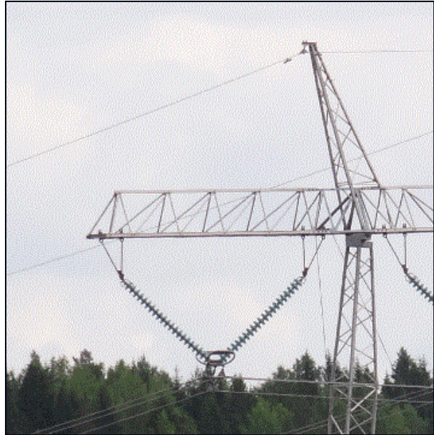
Kuva 6-5. Voimajohtopylvään eristimiä, joissa koronapurkauksia voi esiintyä.
