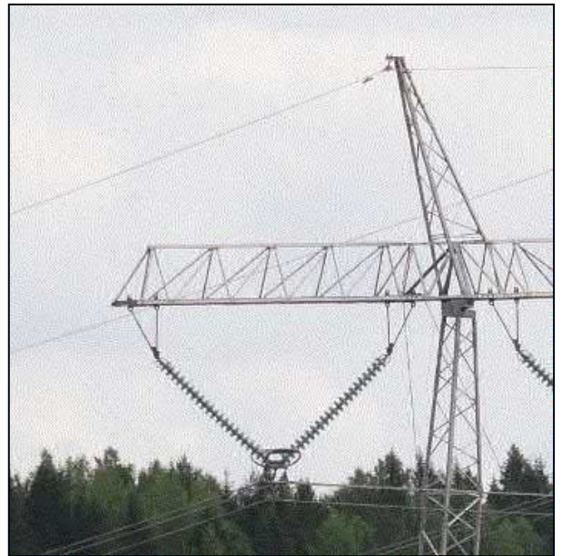
Kuva 10-7. Voimajohtopylvään eristimiä, joissa koronapurkauksia voi esiintyä.
