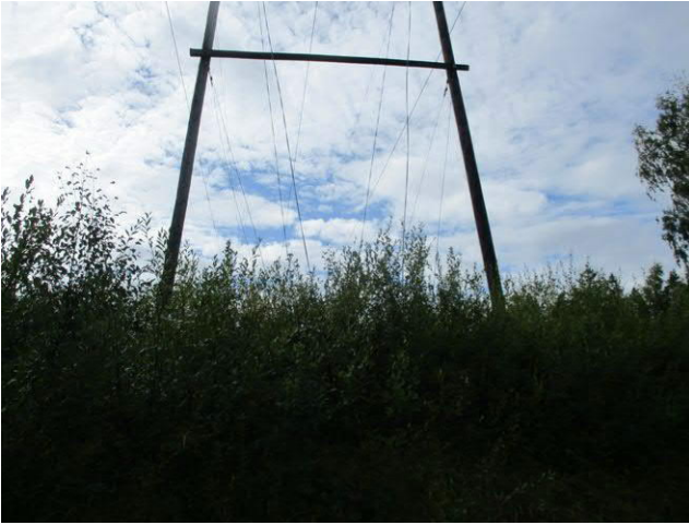
Pylväs 8 (Muuntoasemalta laskettu).
