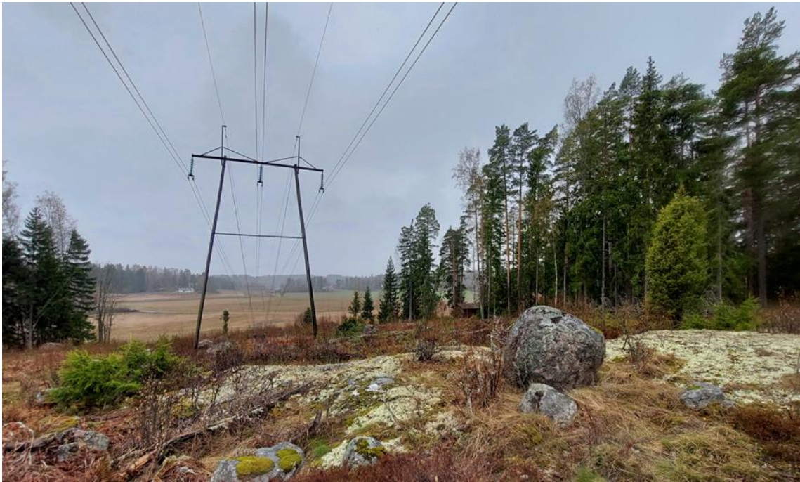
Kuva 40. Voimajohto Luoman kylän kulttuuriympäristön peltoaukeiden pohjoislaidalla. Voimajohtoreitti siirtyy metsäisestä ympäristöstä avoimeen ympäristöön.
