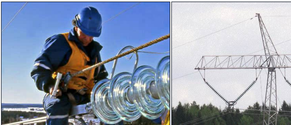
Kuva 6.3. Voimajohtopylvään eristimiä, joissa koronapurkauksia voi esiintyä.
