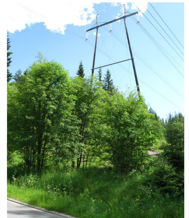
Kuva 18. Kadun ja kevyenliikenteenväylän väliin jätetty liian pitkiä pihlajia
