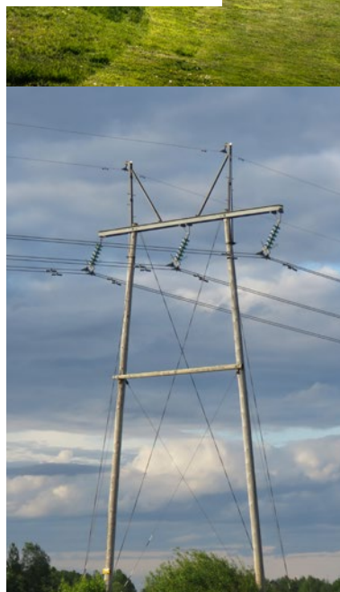
110 kV harustettu puupylväs
