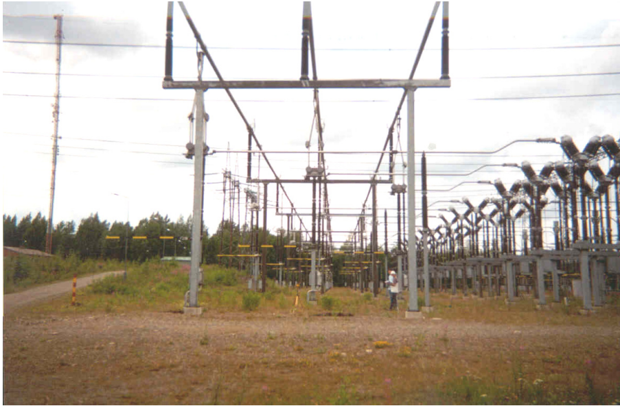
Kuva 4.3. Esimerkki 400 kV sähköaseman pääkiskostosta.
