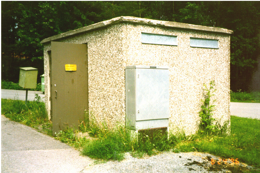
Kuva 4.5. Esimerkki keskijänniteverkon puistomuuntamosta.
