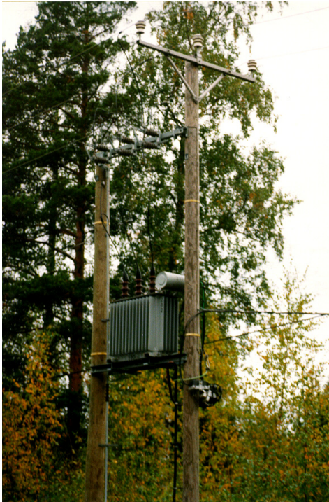
Kuva 4.4. Esimerkkejä keskijänniteverkon pylväsmuuntamoista.
