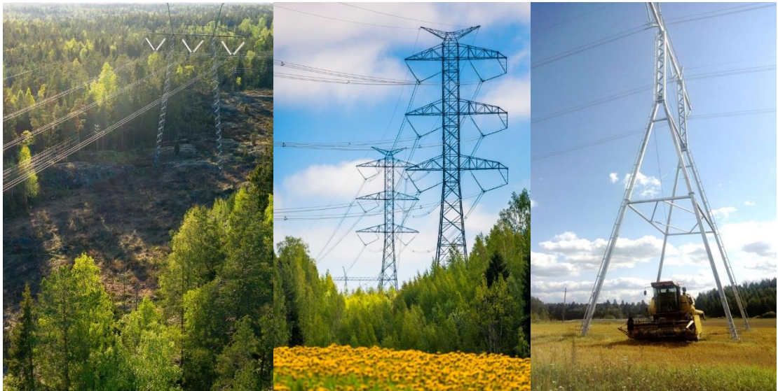
Kuva 4-9. Esimerkkikuvat eri pylvästyypeistä. Vasemmalla haruksin tuettu 400 kilovoltin portaalipylväs, keskellä vapaasti seisova kahden 400 kilovoltin voimajohtopylväs ja oikealla vapaasti seisova harukseton peltopylväs.
