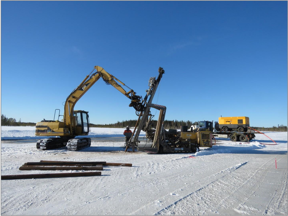
Kuva 3-6. Porapaaluperustuksen tekoa suoalueella, jossa työalue on jäädytetty. Bild 3-6. Konstruktion av borrhade påfundament på ett myrområde där arbetsområdet är nedfruset.
