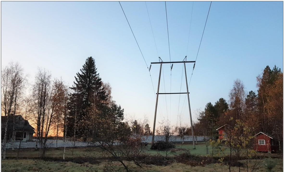
Kuva 4-7. Alakylällä voimajohtoreitin läheisyydessä on koulu (kuvassa vasemmalla) ja asutusta (kuvassa oikealla, katso. maisemasovite liitteessä 4) (kuvaussuunta etelään).
