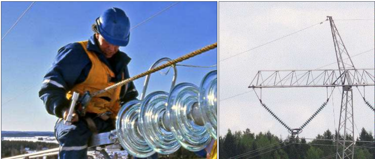
Kuva 87. Voimajohtopylvään eristimiä, joissa koronapurkauksia voi esiintyä.
