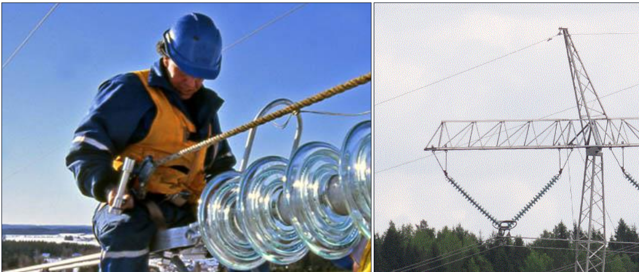
Kuva 75. Voimajohtopylvään eristimiä, joissa koronapurkauksia voi esiintyä.
