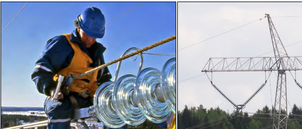
Kuva 104. Voimajohtopylvään eristimiä, joissa koronapurkauksia voi esiintyä.
