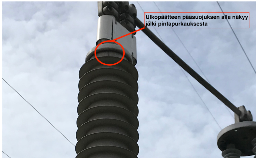
Kuva 20. Sähköasema 1:sen 16 lähtö päätte 1.
