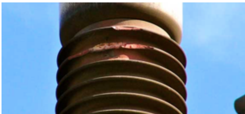
Kuva 2. Osittaispurkauksen aiheuttama eristevaurio [24].
