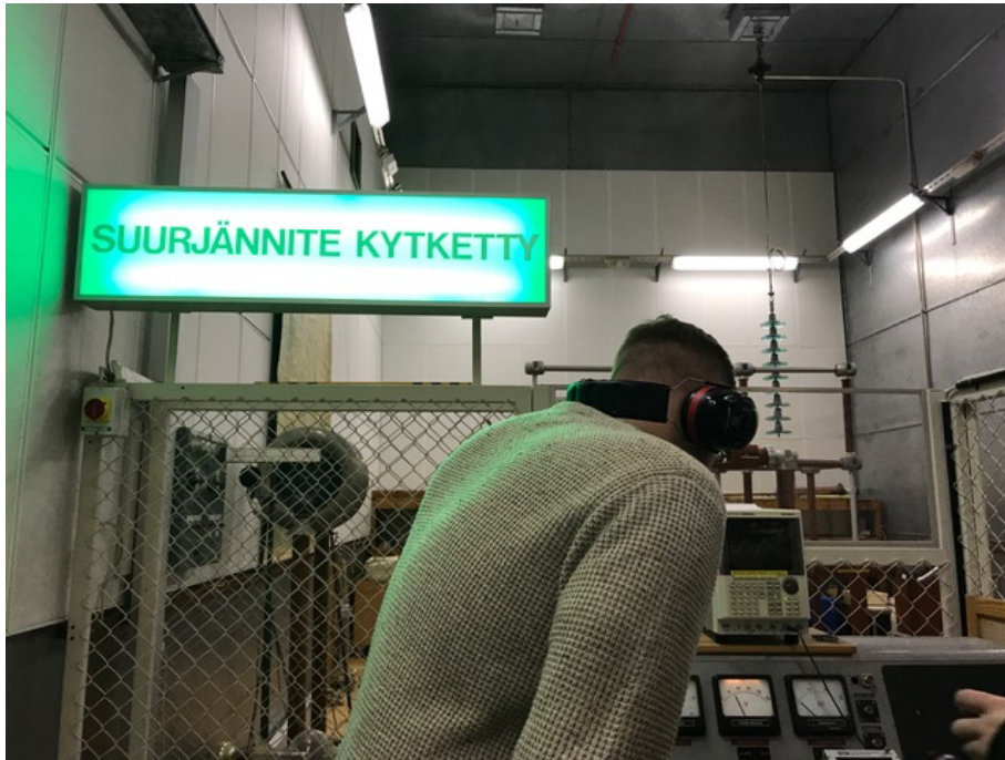
Kuva 11. Suurjännitelaboratorion muuntajan ohjauskeskus ja mittarit.
