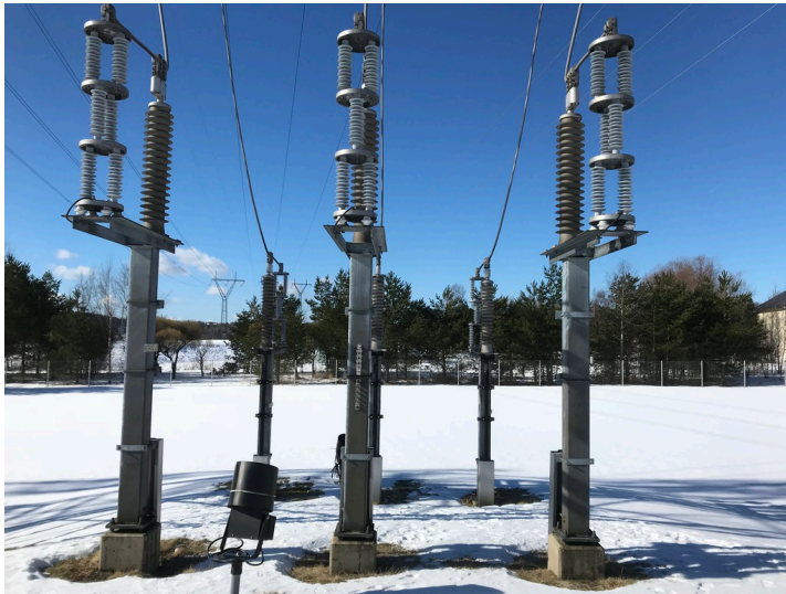
Kuva 15. Ulkopäätteet 110 kV:n sähköasemalla talvella.
