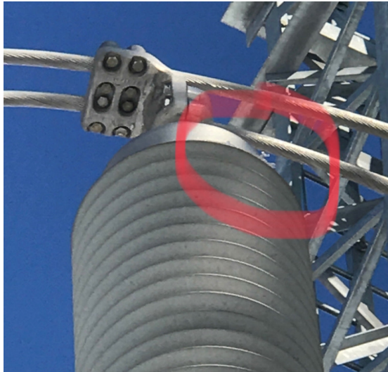
Kuva 16. Pääte 6: Osittaispurkauksia aiheuttava jääpiikki.
